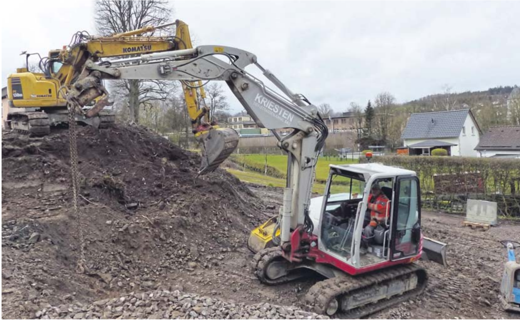
Unterhalb der Bergstraße müssen rund 600 Kubikmeter Boden ausgetauscht werden. Dort entsteht ein Teil der Park-and-Ride-Anlage. FOTOS: OFFERMANN
